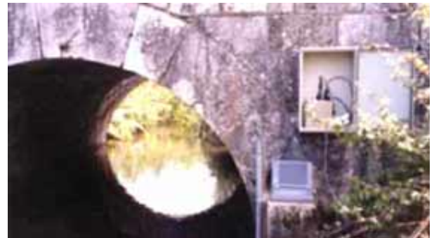
Dispositif de mesure à l'exutoire
